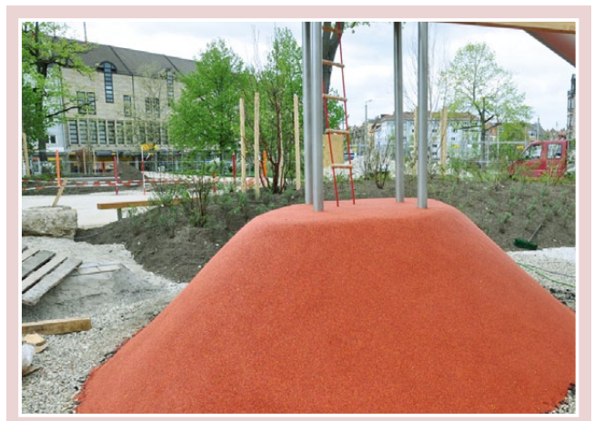
Abbildung 13: In einem zweiten Arbeitsschritt wird der farbige EPDM - Fallschutzbelag in einem Arbeitsgang ohne Fugen aufgebracht.
